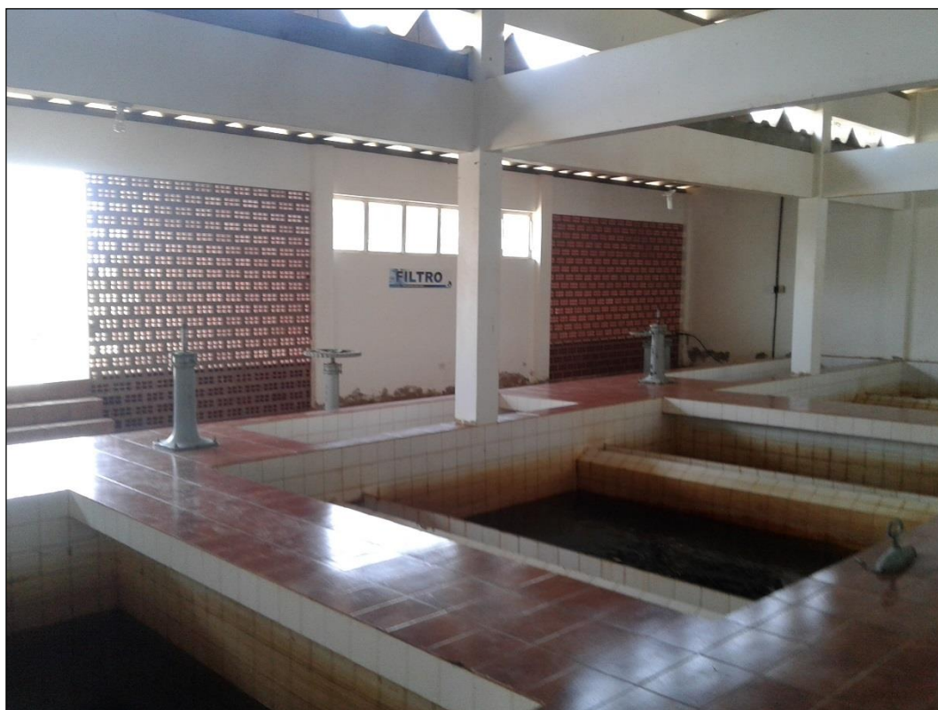
Figura 41 – Filtros da ETA: Distrito Sede. Fonte: DRZ – Geotecnologia e Consultoria, 2017.
