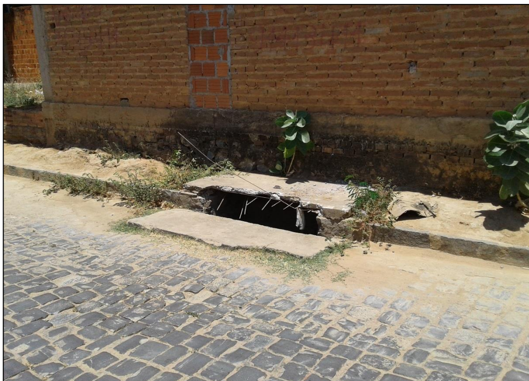
Figura 141 - Estrutura de captação do tipo lateral – Distrito Sede. Fonte: DRZ – Geotecnologia e Consultoria, 2017.
