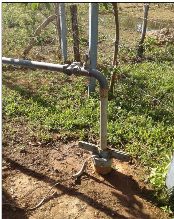
Figura 72 – Captação de poço do povoado Água Quente – P3.
