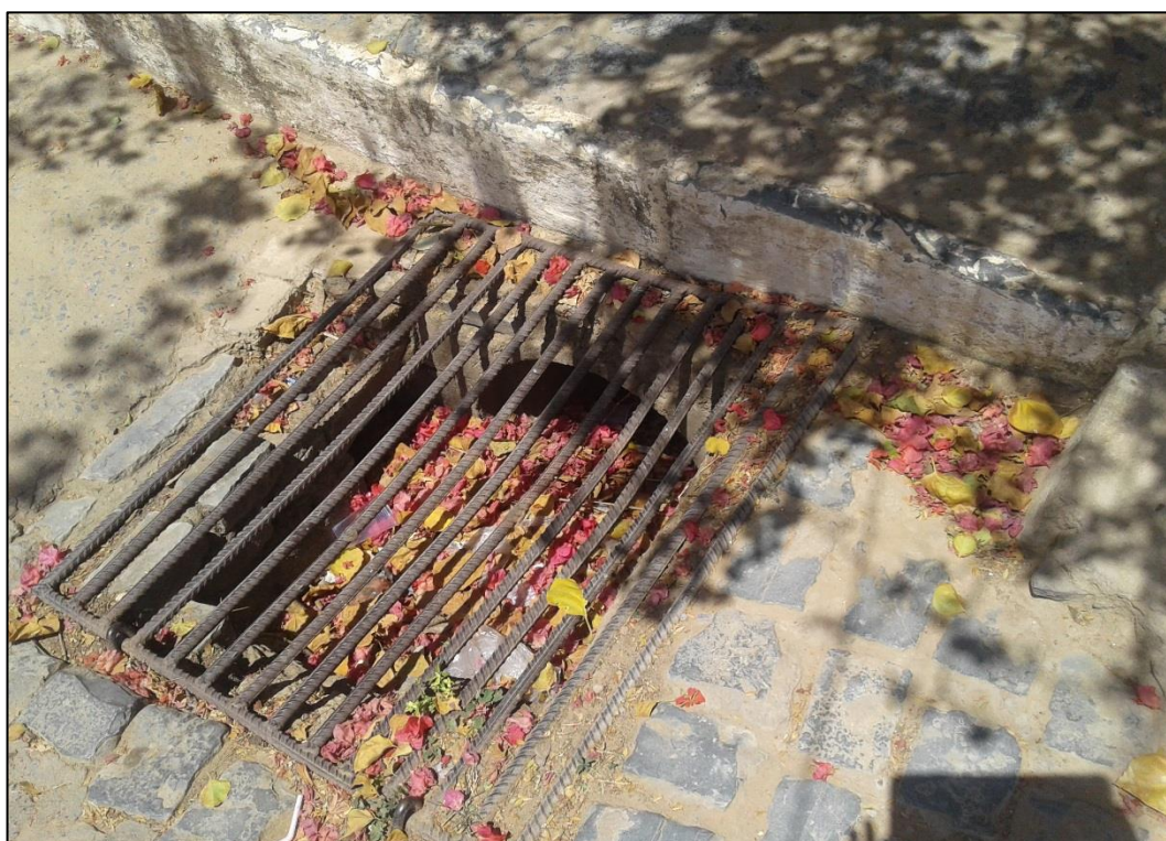
Figura 142 - Estrutura de captação do tipo grelha – Distrito Sede. Fonte: DRZ – Geotecnologia e Consultoria, 2017.
