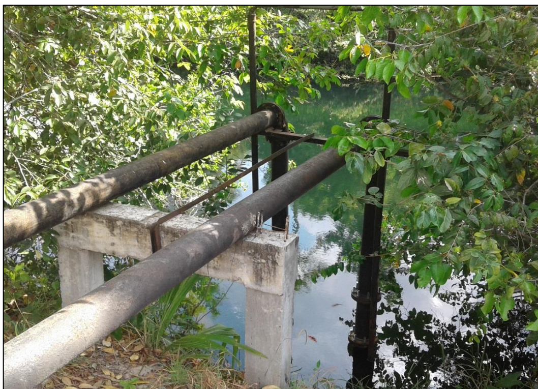
Figura 57 – Captação superficial do distrito de Inhaúmas. Fonte: DRZ – Geotecnologia e Consultoria, 2017.
