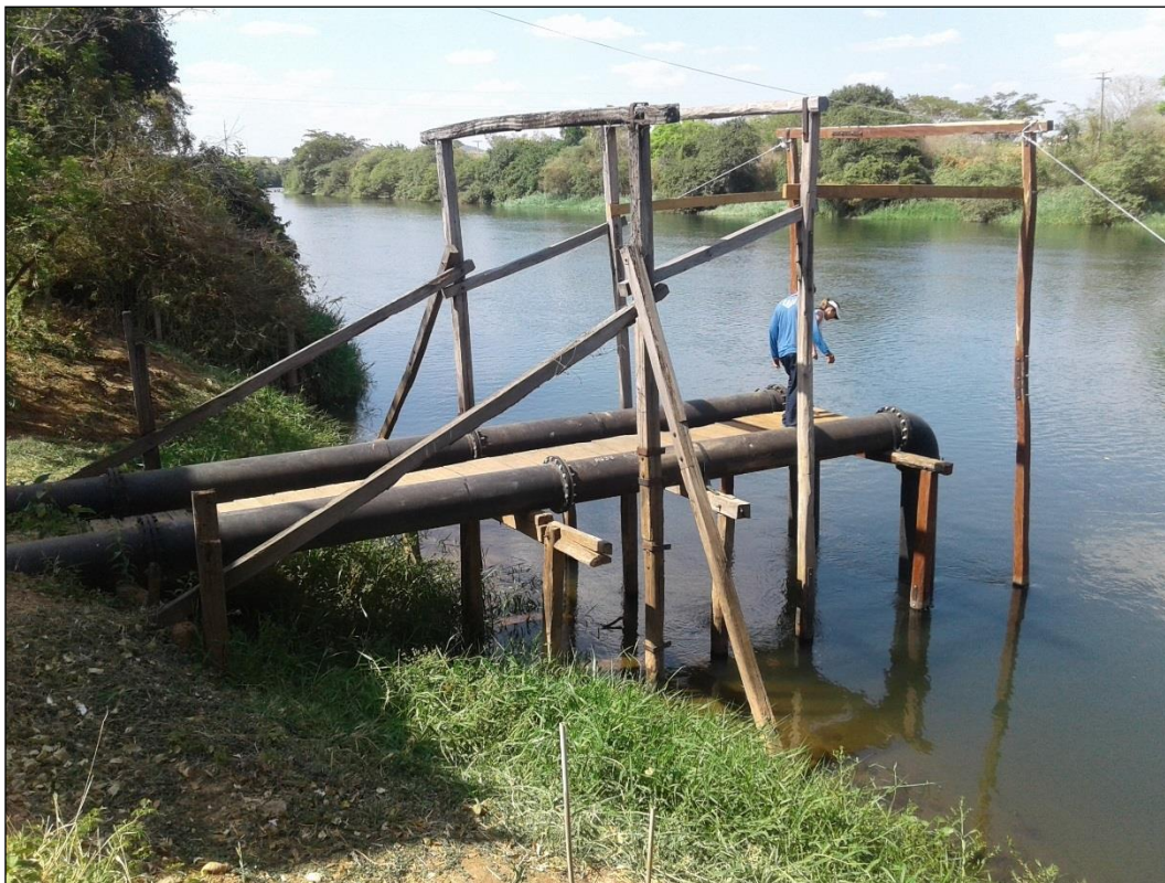
Figura 24 – Captação superficial no Rio Corrente - Distrito Sede. Fonte: DRZ – Geotecnologia e Consultoria, 2017.
