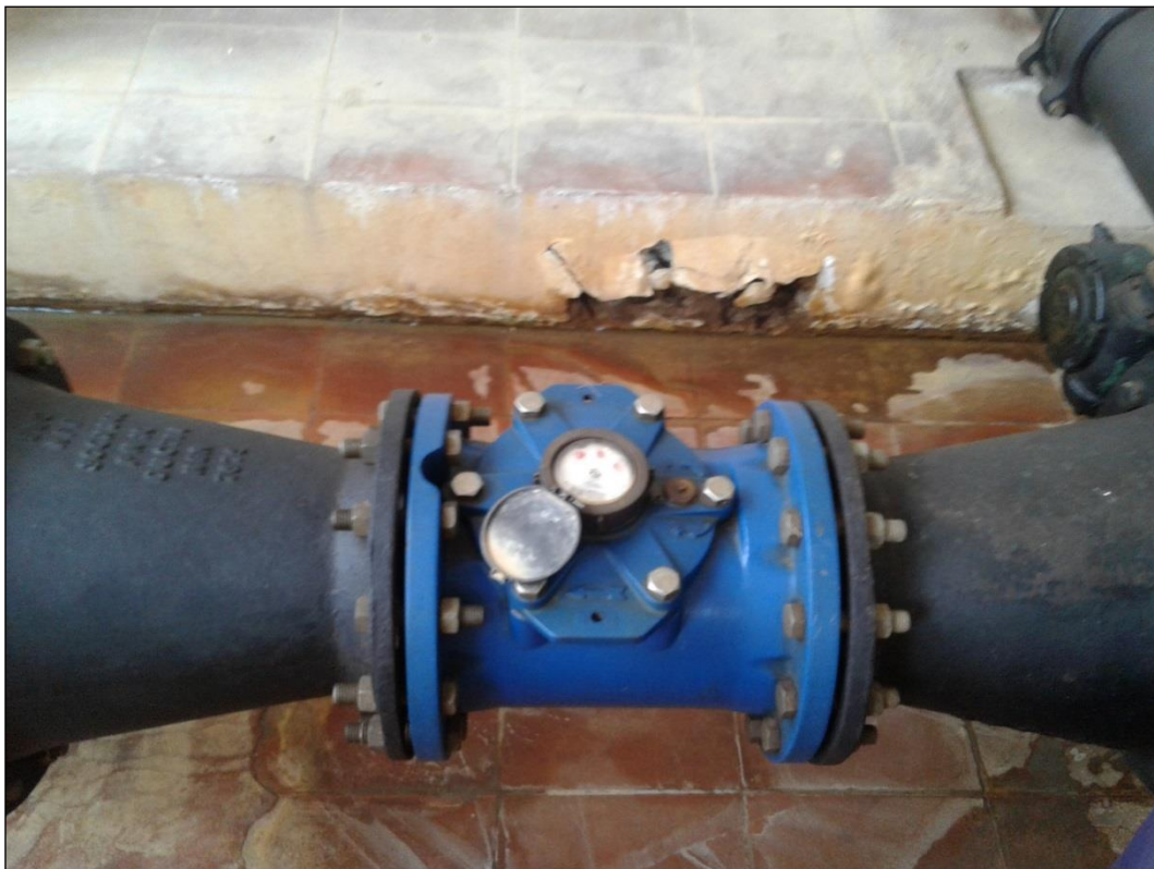
Figura 49 – Macromedidor na saída da ETA.
