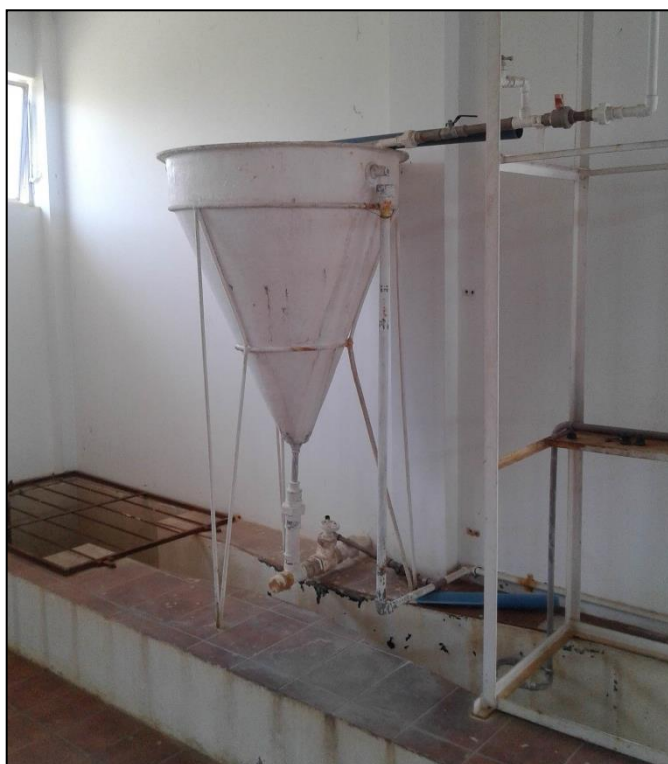
Figura 48 – Adição de flúor e medição de vazão na saída da ETA. Fonte: DRZ – Geotecnologia e Consultoria, 2017.
