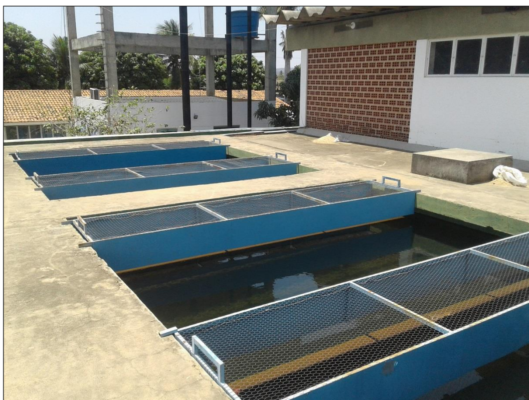
Figura 39 – Decantadores da ETA: Distrito Sede. Fonte: DRZ – Geotecnologia e Consultoria, 2017.
