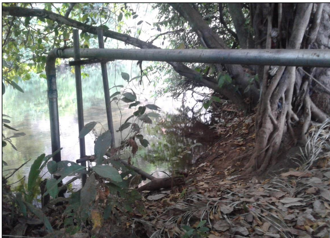
Figura 97 – Captação por bomba superficial do povoado de Ponte Velha. Fonte: DRZ – Geotecnologia e Consultoria, 2017.
