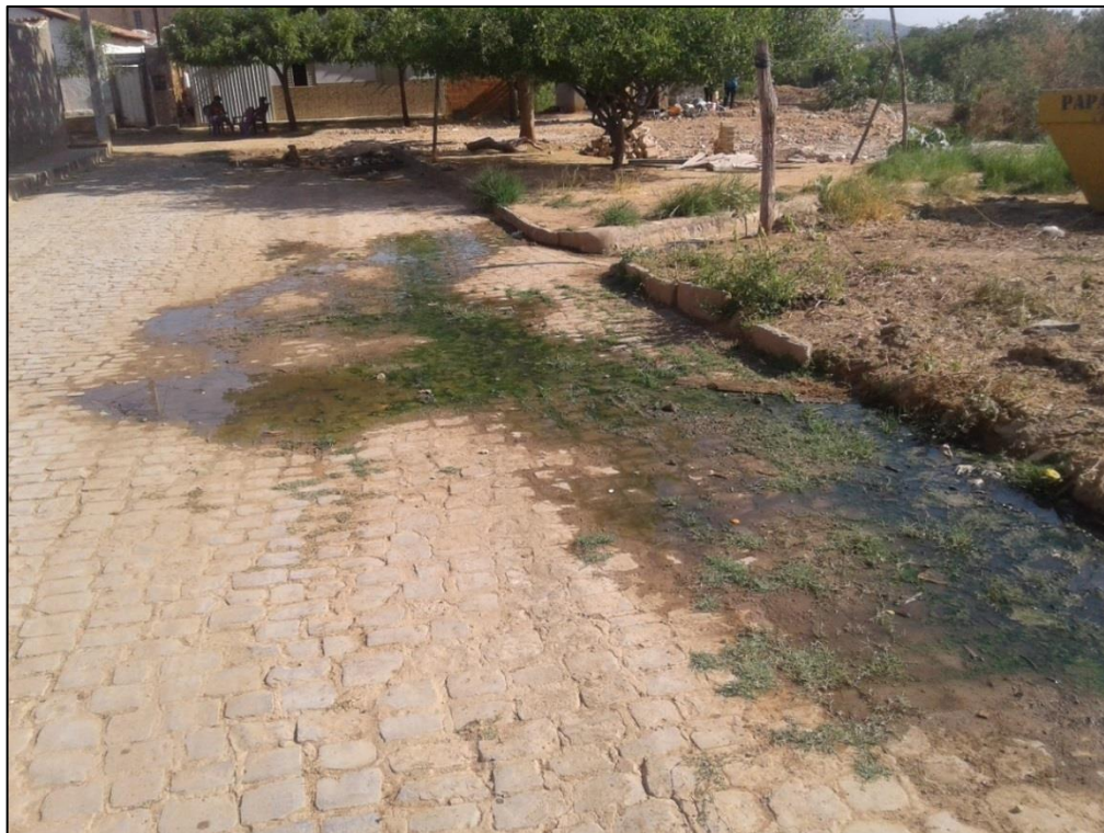
Figura 114 – Lançamento irregular de esgoto em via pública
