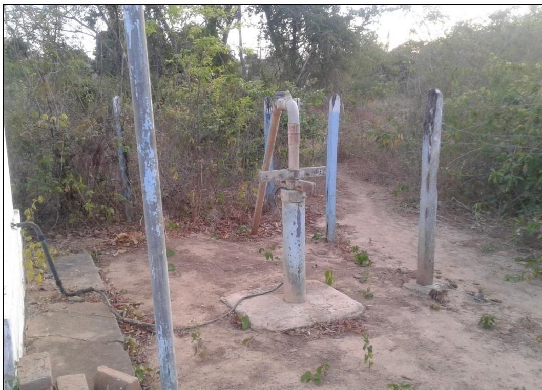
Figura 54 – Captação de poço do distrito de Açudina.
