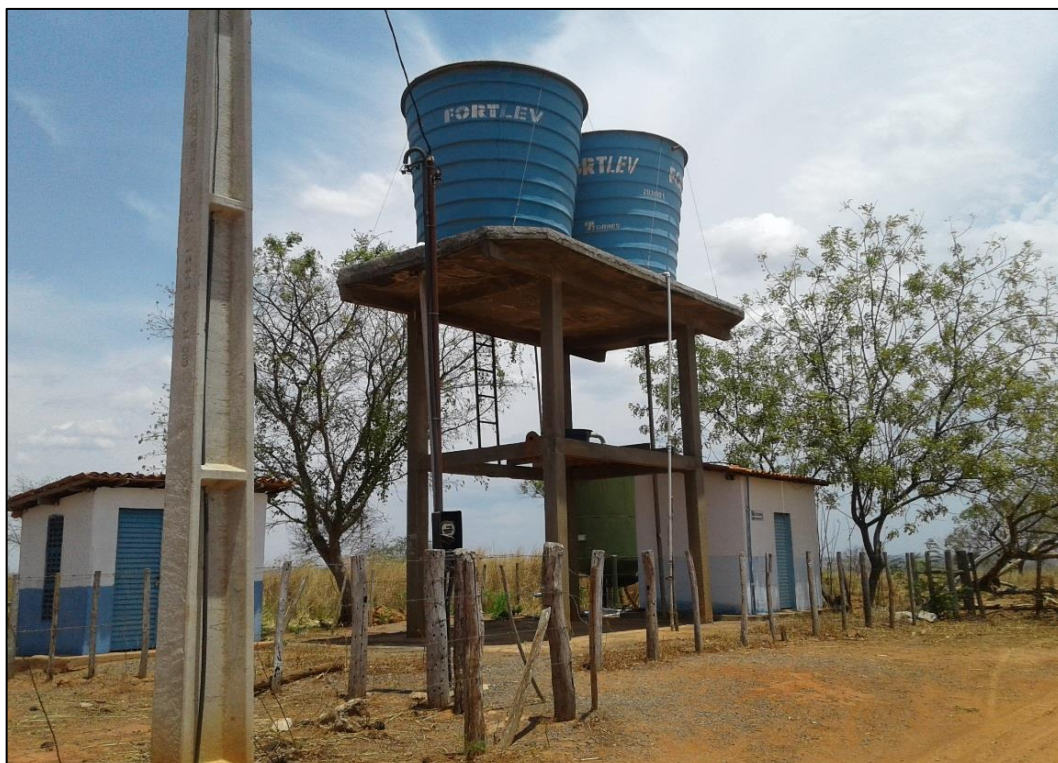
Figura 79 – ETA com REL 1 e REL 2 e filtro russo do povoado Caniveta. Fonte: DRZ – Geotecnologia e Consultoria, 2017.
