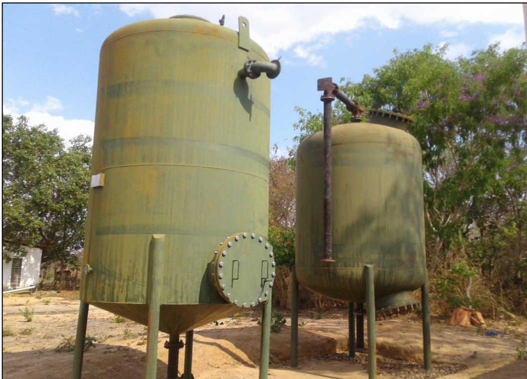
Figura 60 – Decantadores desativados do distrito de Inhaúmas. Fonte: DRZ – Geotecnologia e Consultoria, 2017.
