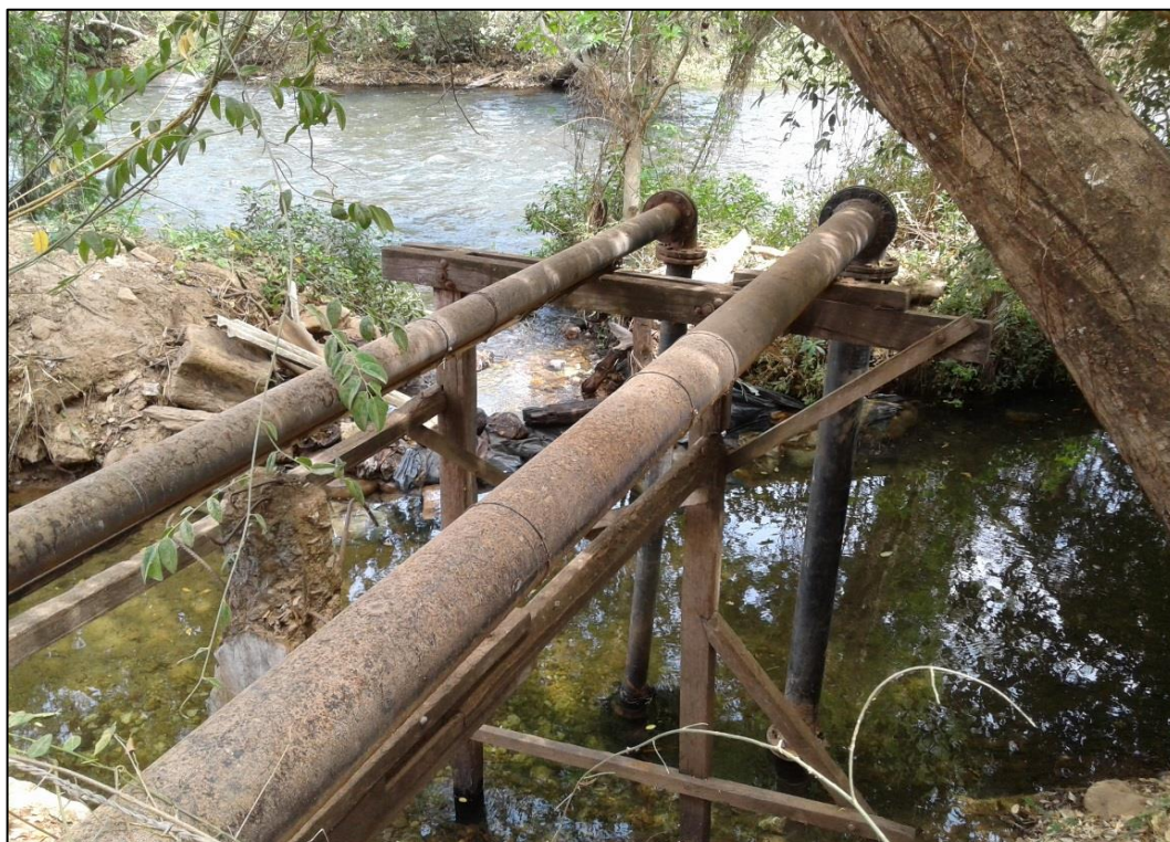
Figura 91 – Captação por bomba superficial do povoado Mucambo.
