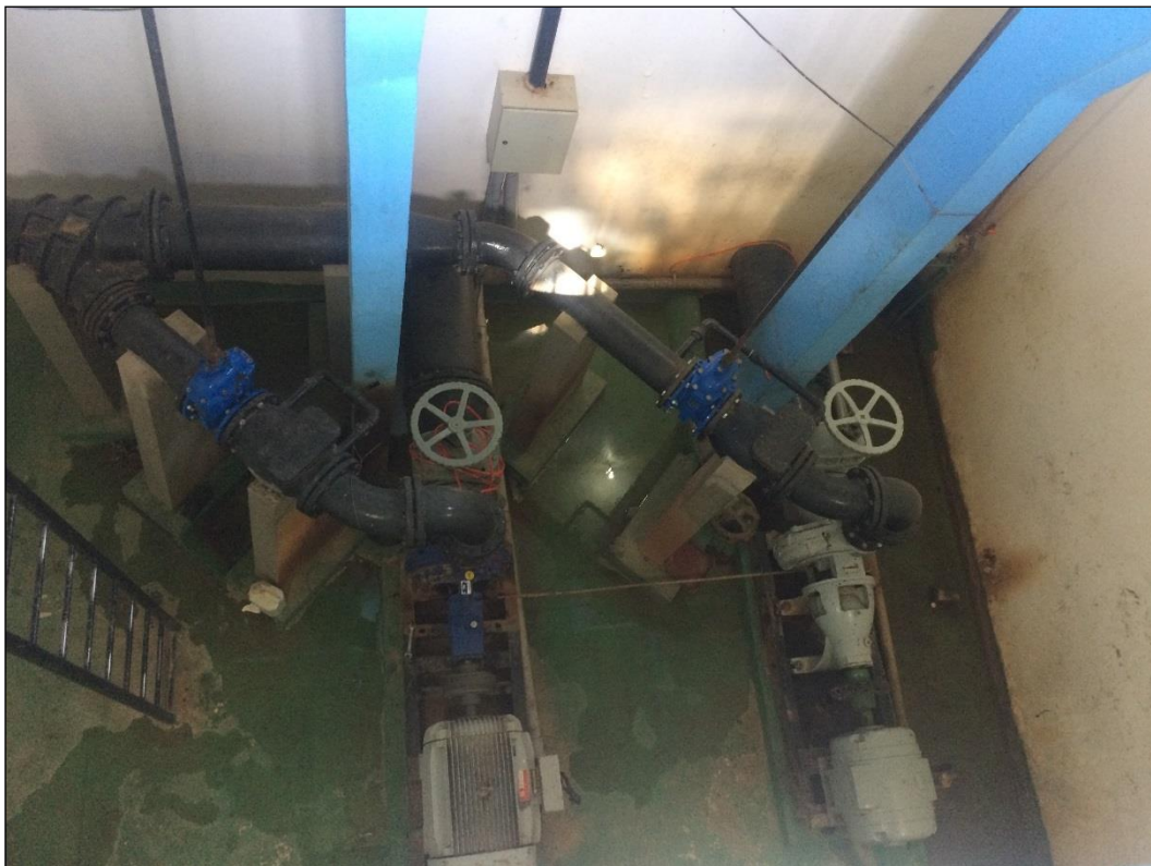
Figura 28 – Bombas de Captação. Fonte: DRZ – Geotecnologia e Consultoria, 2017.
