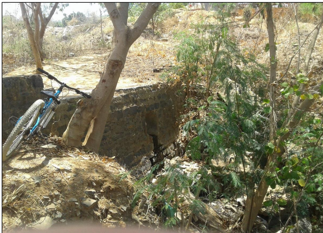
Figura 143 - Lançamento de efluente de esgoto doméstico em rede de drenagem.
