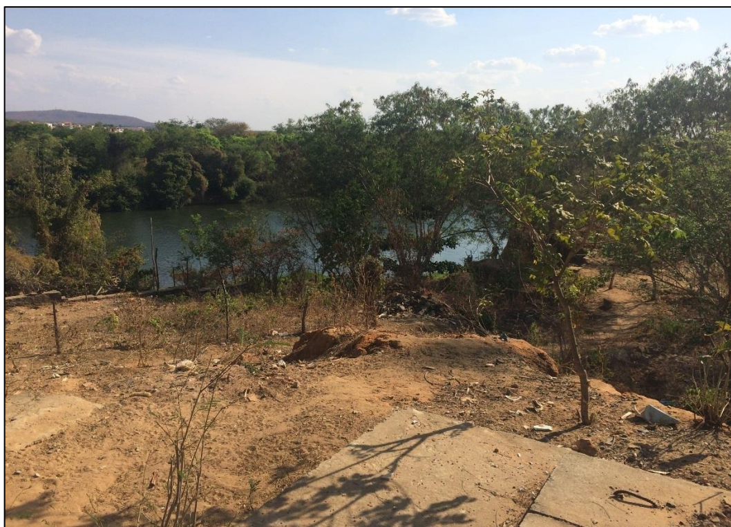
Figura 159 - Erosão do Bairro Sambaíba. Fonte: DRZ – Geotecnologia e Consultoria, 2017.
