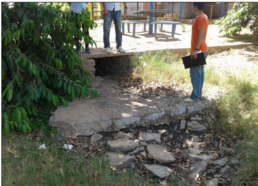
Figura 146 - Ponto de lançamento de rede de drenagem não cadastrada. Fonte: DRZ – Geotecnologia e Consultoria, 2017.
