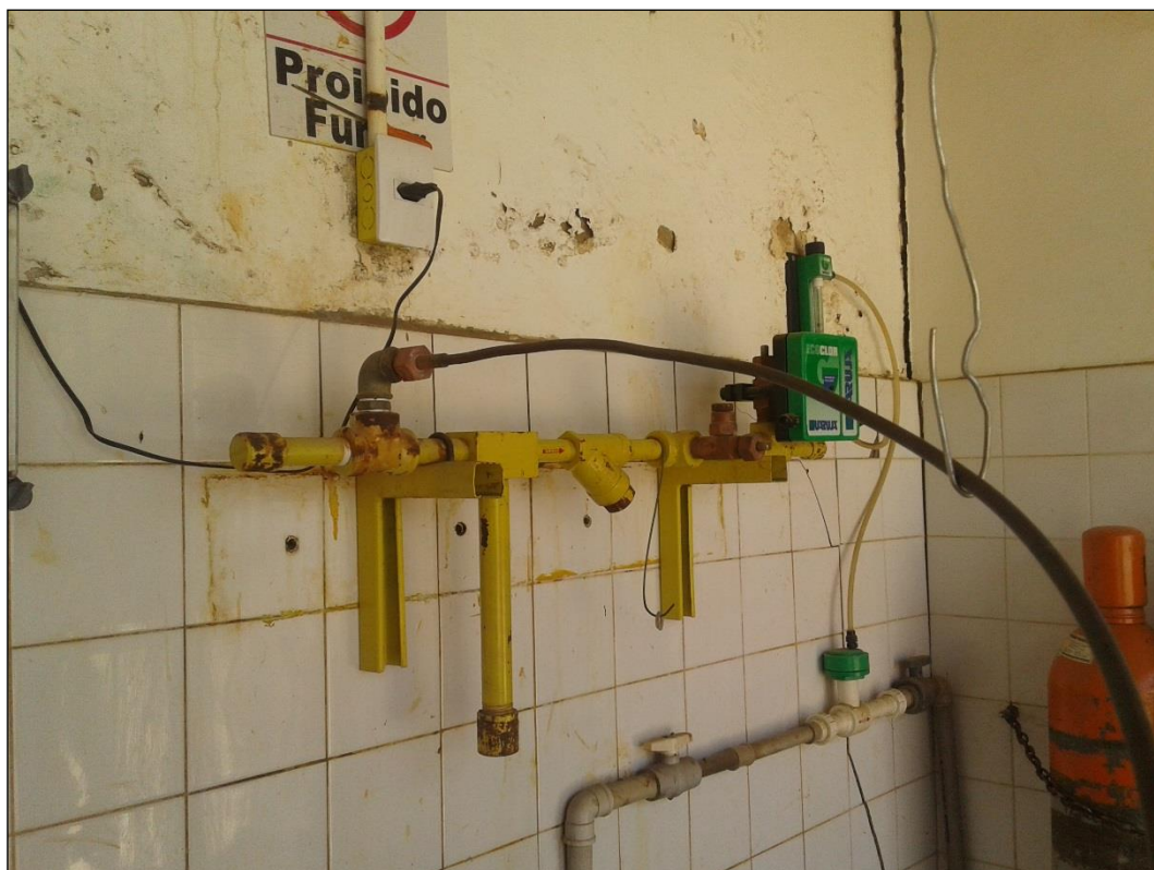
Figura 43 – Dosador de cloro gás. Fonte: DRZ – Geotecnologia e Consultoria, 2017.
