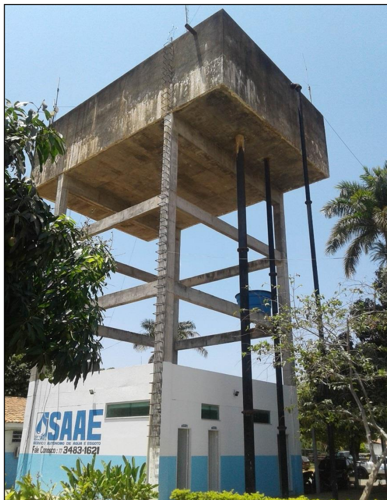
Figura 50 – R1 – Reservatório Elevado. Fonte: DRZ – Geotecnologia e Consultoria, 2017.
