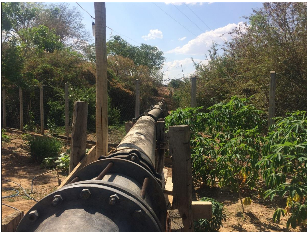
Figura 31 – Adutora de Água Bruta. Fonte: DRZ – Geotecnologia e Consultoria, 2017.
