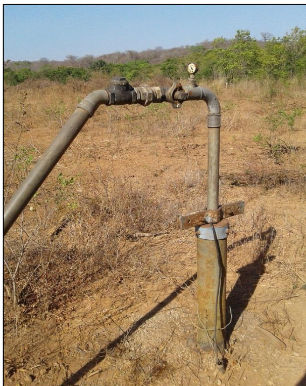
Figura 74 – Captação de poço do povoado Água Quente – P4. Fonte: DRZ – Geotecnologia e Consultoria, 2017.
