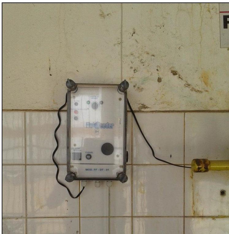
Figura 45 – Detector de vazamento de cloro gás. Fonte: DRZ – Geotecnologia e Consultoria, 2017.
