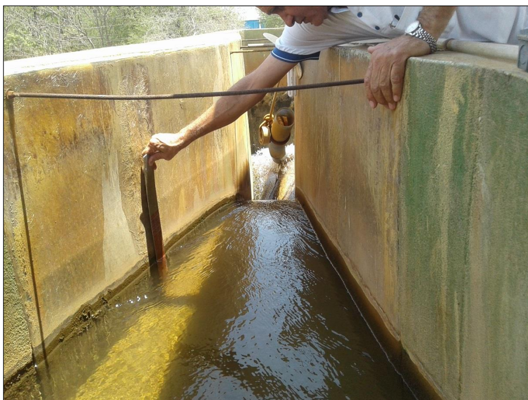
Figura 37 – Calha parshall e adição de sulfato de alumínio: Distrito Sede. Fonte: DRZ – Geotecnologia e Consultoria, 2017.
