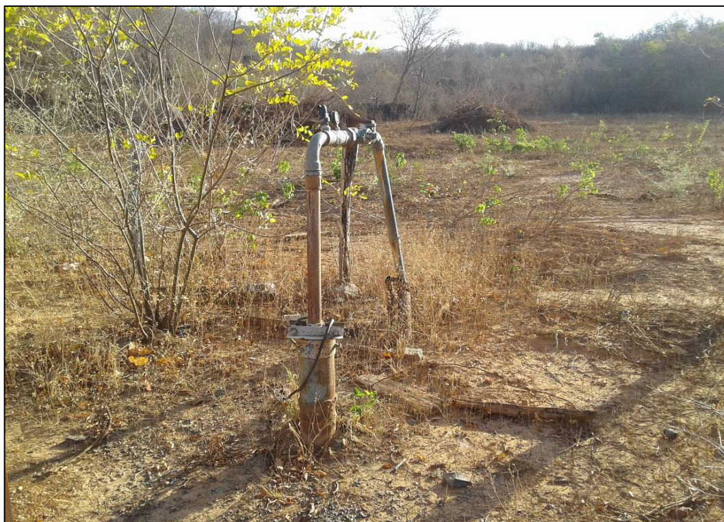
Figura 70 – Captação de poço do povoado Água Quente – P2. Fonte: DRZ – Geotecnologia e Consultoria, 2017.
