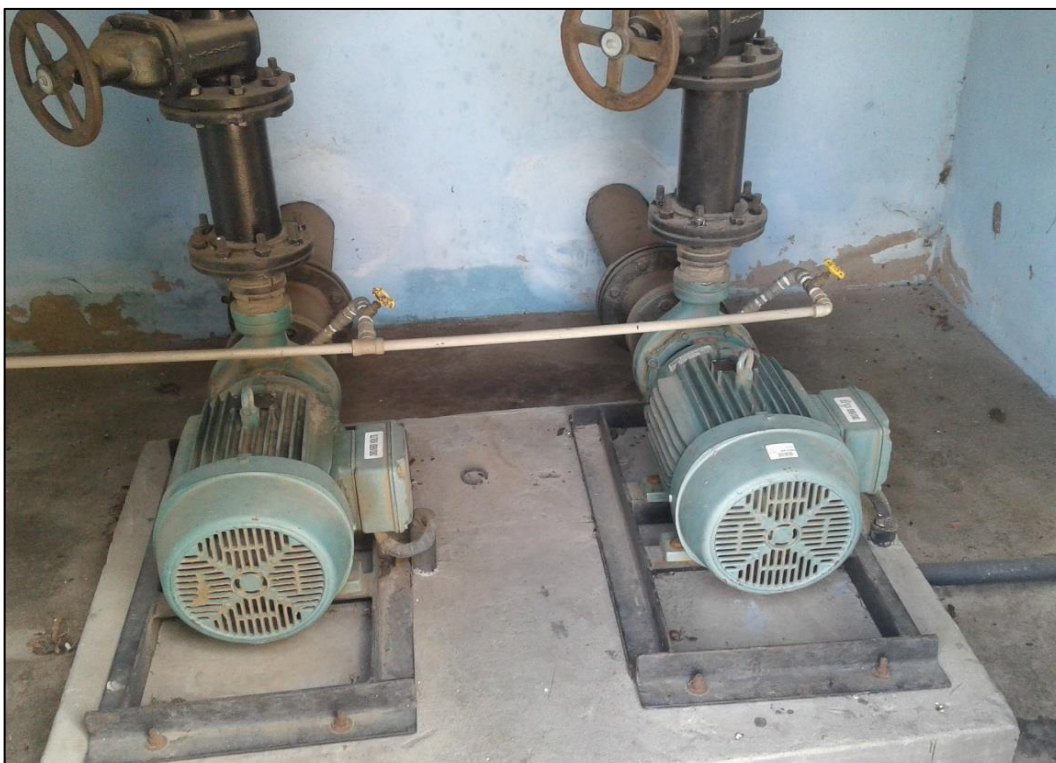
Figura 58 – Bombas de captação superficial do distrito de Inhaúmas. Fonte: DRZ – Geotecnologia e Consultoria, 2017.
