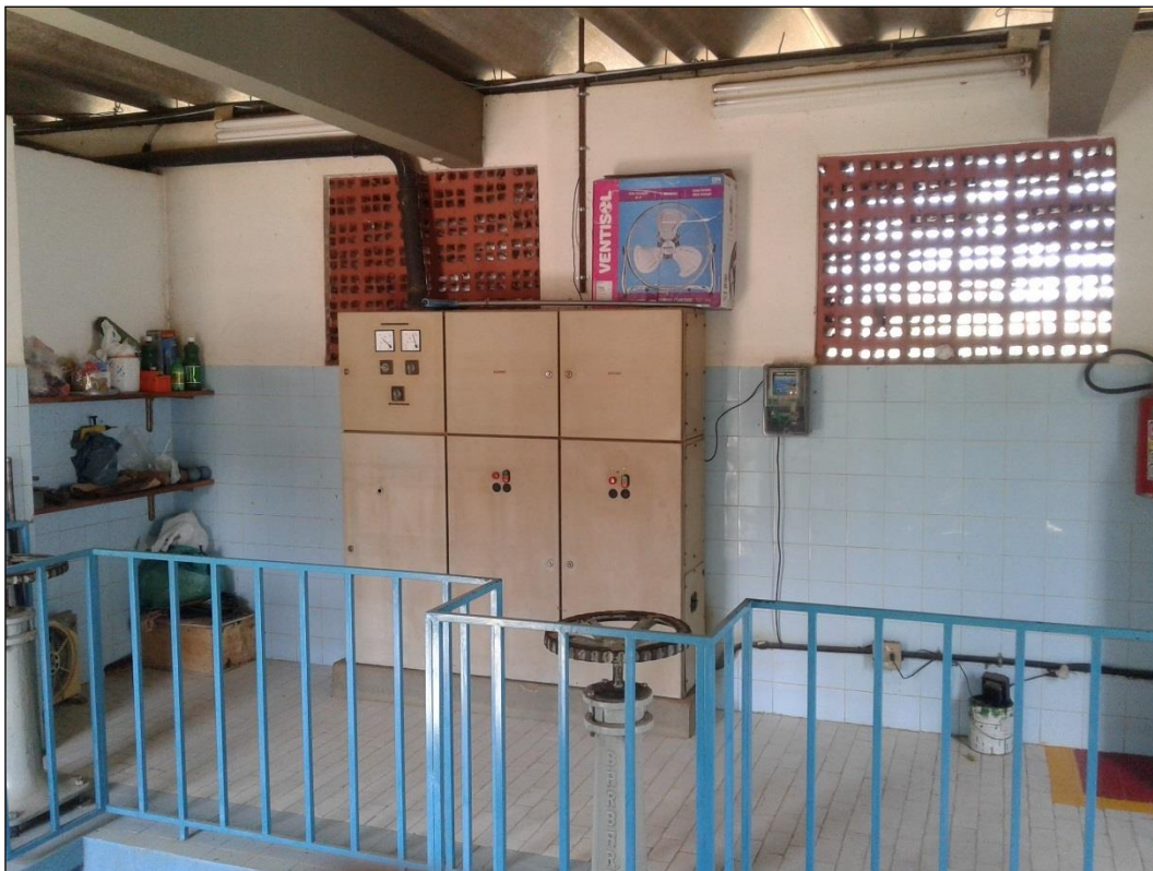
Figura 27 – Painel de comando e controle manual das bombas.
