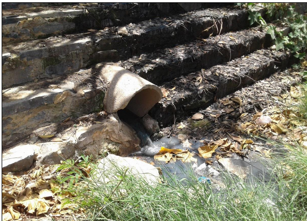
Figura 144 - Lançamento de efluente de esgoto doméstico em rede de drenagem.
