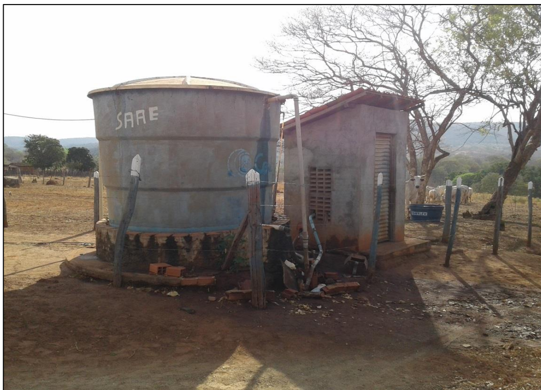
Figura 88 – RAP 3 do povoado de Montividinha, Caruaru e Currais. Fonte: DRZ – Geotecnologia e Consultoria, 2017.
