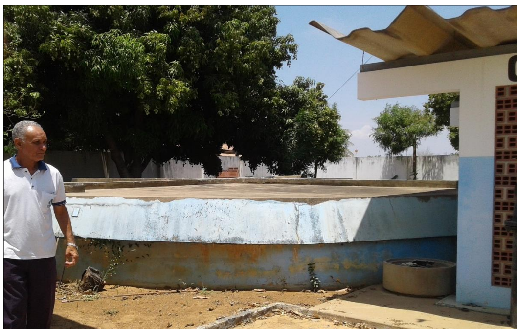
Figura 51 – Reservatório Enterrado. Fonte: DRZ – Geotecnologia e Consultoria, 2017.
