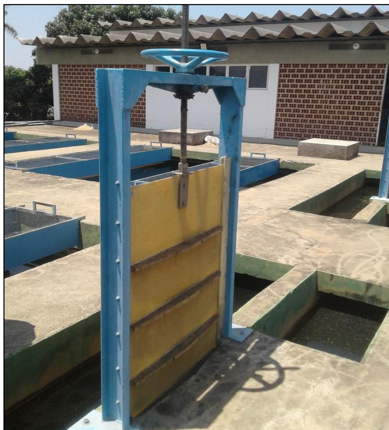
Figura 40 – Comportas para setorização do sistema. Fonte: DRZ – Geotecnologia e Consultoria, 2017.
